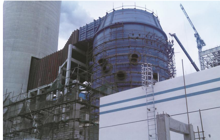
电厂烟气净化脱硫脱硝
