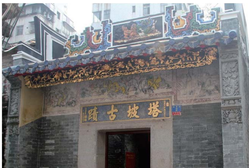
图十 在施工过程采用手工对灰水进行清理，清理后清代壁画和砖墙的原貌得以重现
